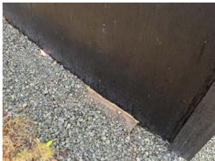
Manglende lufting av fasadeplater.
