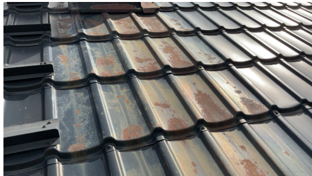
Rustskader på takteking nedenfor pipe og rust på pipebeslag
