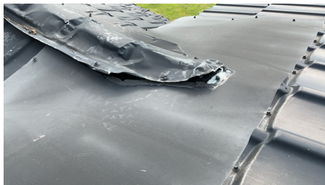
Skade på tekking med utettheter i overgang
