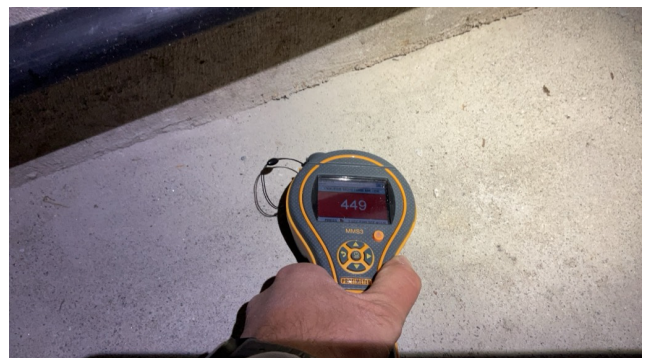
Ved overflatesøk med fuktmåler av gulv på grunn var det fuktutslag
