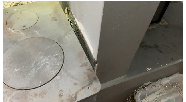
Ovn er plassert for nær, samt avlassong av mur
