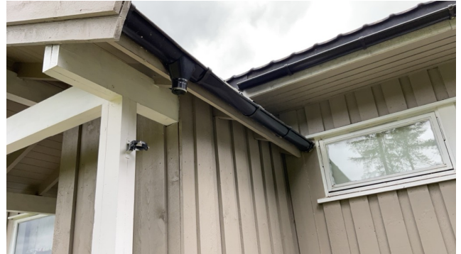
Skade på takrenne og manglende nedløp
