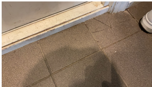
Sprekk i flis og sprekker i fuger som følge av bom (hullrom) mot undergulv
