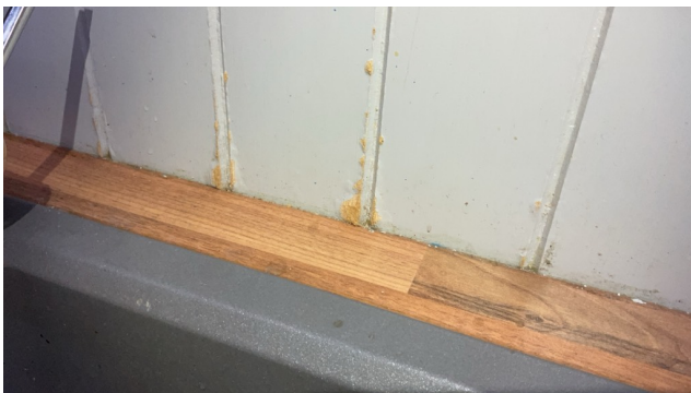
Veggplater har skader og oppsvulming av fukt el
