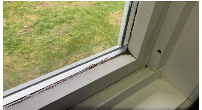
Svertesopp i karm på soverom, nørliggende som følge av inneklime der bedre lufting bør foretas.
