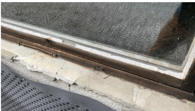
Kjellervindu er slitt med sprekker i kitt
