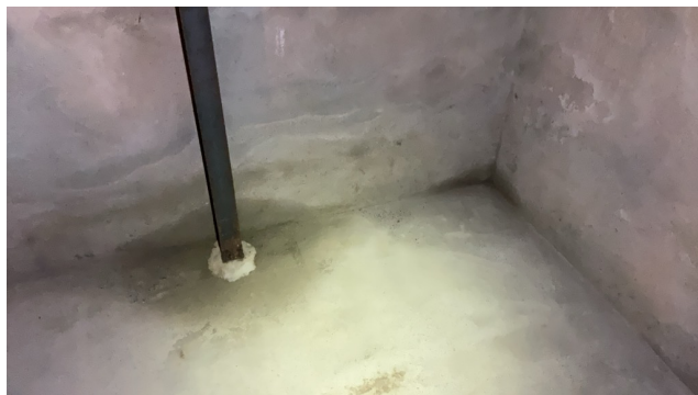
Bemerket fuktgjennomtrengning og bruk av kjeller bør ikke endres
