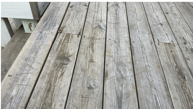
Slitasje på overflate
