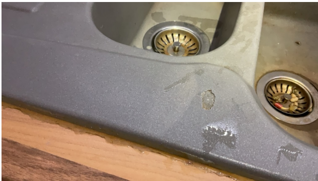
Det er registrert sårskade på oppvaskkum
