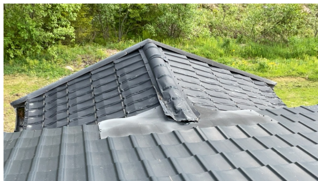
Nedbøyninger av tekking overbygg mot nordlig retning
