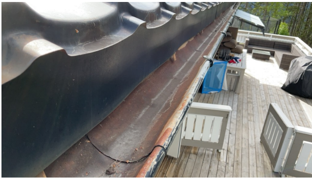
Slitasje med rust på takrenne
