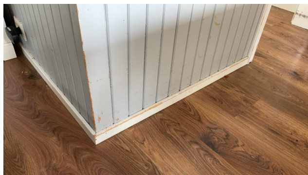
Slitasje på overflater
