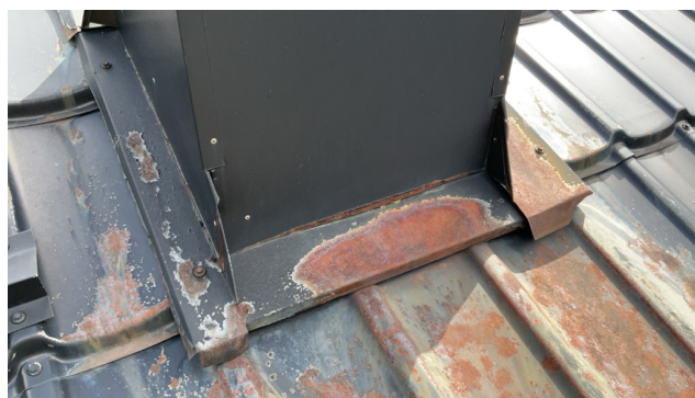
Rust på beslag
