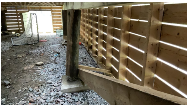
Fundamenter med pilarer av strømsolper ned på betongfundament, registrert skjevhet i pilar
