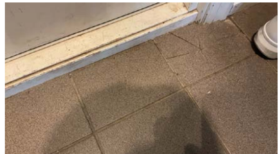
Sprekk i flis og sprekker i fuger som følge av bom (hullrom) mot undergulv
