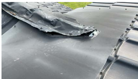
Skade på tekking med utettheter i overgang
