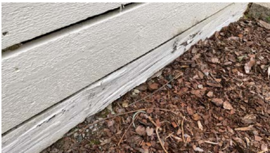
Råte i dekkbord i front av terrassen, ligger nært terreng og utsatt for fuktpåkjenning
