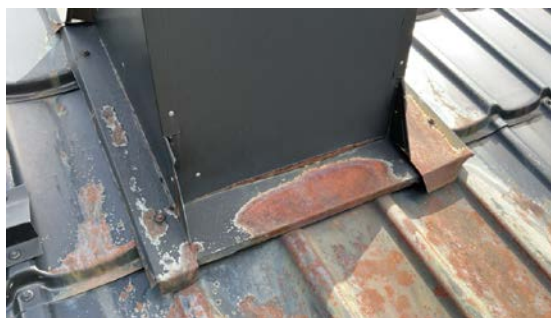
Rust på beslag
