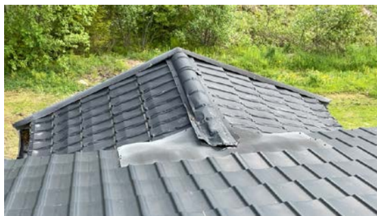
Nedbøyninger av tekking overbygg mot nordlig retning
