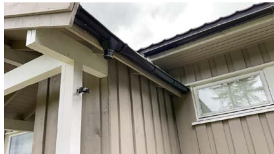
Skade på takrenne og manglende nedløp
