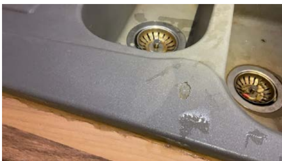
Det er registrert sårskade på oppvaskkum
