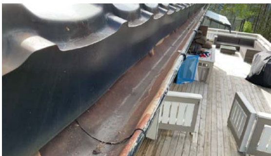
Slitasje med rust på takrenne
