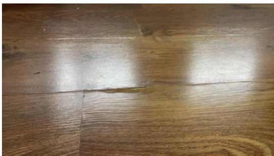
Skader på overflate
