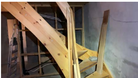
Manglende rekkverk på en side av trappen, samt åpninger i rekkverk på motsatt side og mellom trinn som er over krav.
