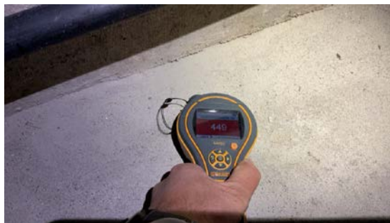
Ved overflatesøk med fuktmåler av gulv på grunn var det fuktslag
