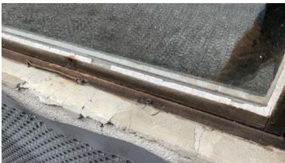
Kjellervindu er slitt med sprekker i kitt
