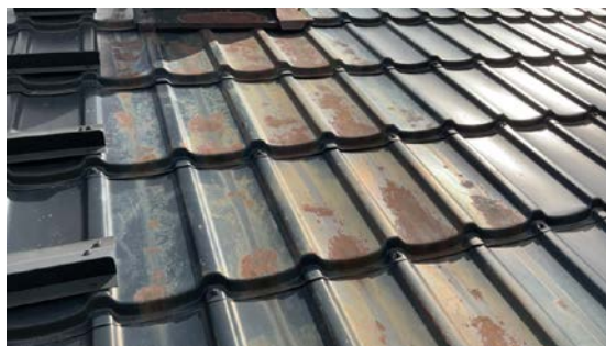
Rustskader på taktekking nedenfor pipe og rust på pipebeslag
