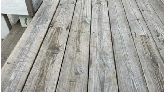
Slitasje på overflate
