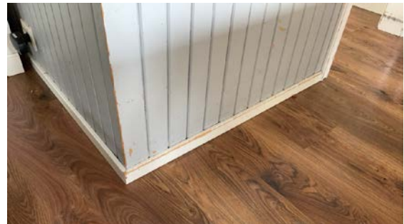
Slitasje på overflater
