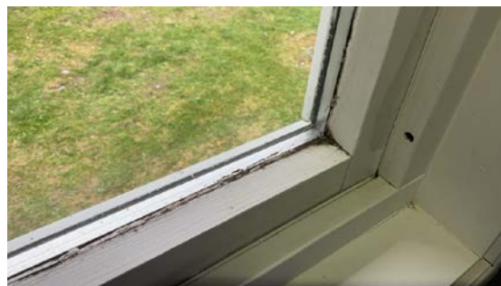
Svertesopp i karm på soverom, nørliggende som følge av innklima der bedre lufting bør foretas.
