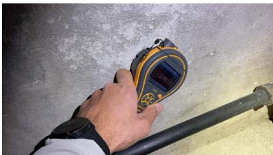
Ved overflatesøk med fuktmåler på yttermur var det fuktutslag
