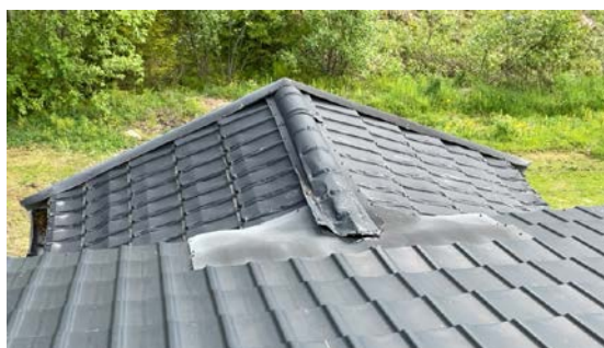
Nedbøyninger av tekking overbygg mot nordlig retning
