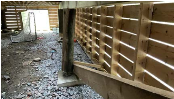
Fundametert med pilarer av strømstolper ned på betongfundament, registert skjevhet i pilar
