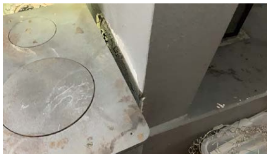
Ovn er plassert for nær, samt avflassing av mur
