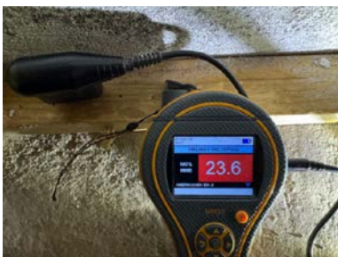
Fuktindikasjon ved søk med pigger i bunnsvill
