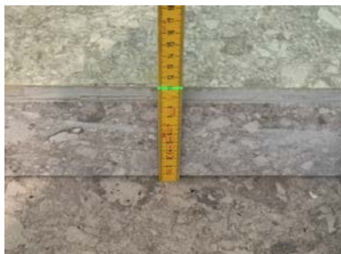
Fallforhold ca. 110 mm overkant gulv ved dør/terskel
