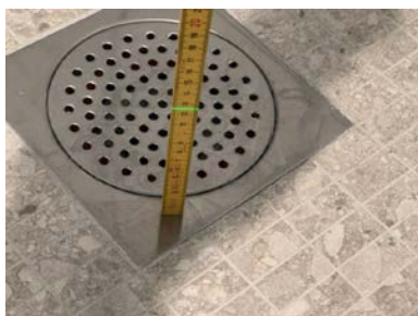
Fallforhold ca. 125 mm topp slukrist i dusjsone
