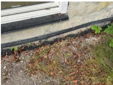
Åpning/glippe mellom klemlist og grunnmursplast
