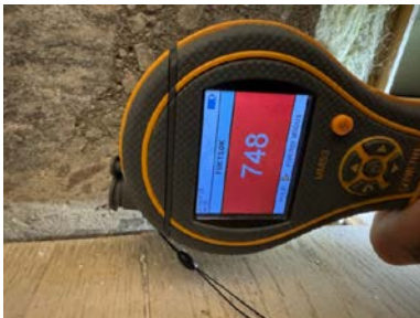
Fuktindikasjon nedkant grunnmur/kjellervegg
