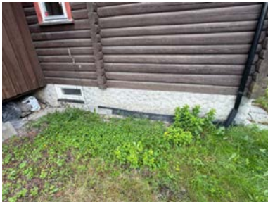
Åpning/glippe mellom klemlist og grunnmursplast
