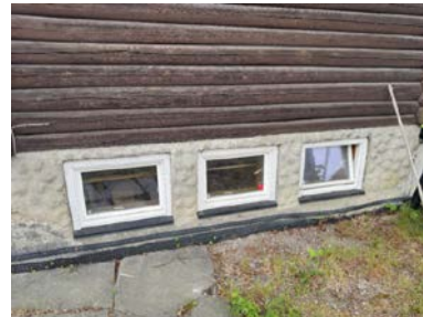
Åpning/glippe mellom klemlist og grunnmursplast
