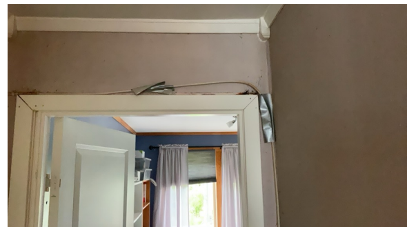
Løse ledninger festet med tape.
