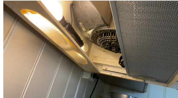
det mangler rist på ventilator.
