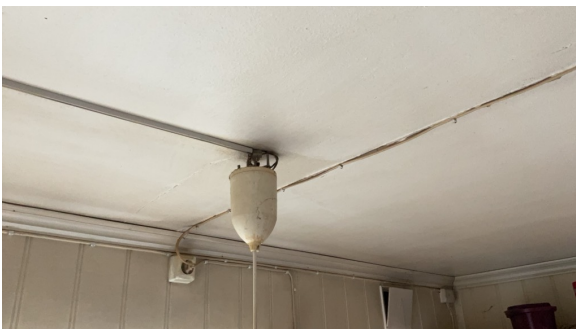
Åpen kobling ved taklampe på kjøkken.
