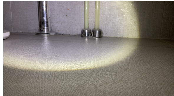
Utilfredstillende tetting ved rørgjennomganger
