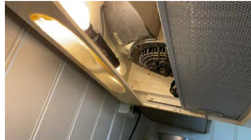
det mangler rist på ventilator.
