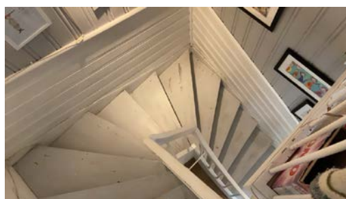
Trappen har en del slitasjegrad utover det som er normalt ut ifra alder.
