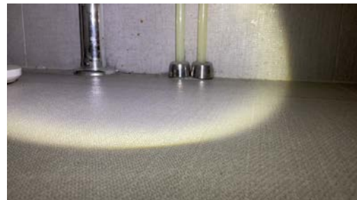
Utilfredstillende tetting ved rørgjennomganger
