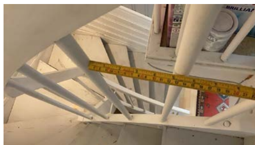
Åpninger i rekkverk er større enn dagens forskriftskrav til rekkverk i trapper.
