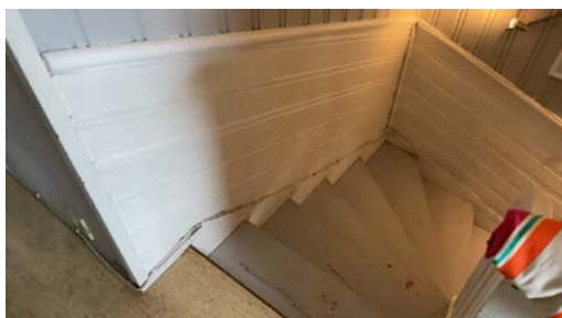
Det mangler håndløper på vegg i trappeløpet.
