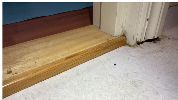
Ingen synlig oppbrett ved terskel.
