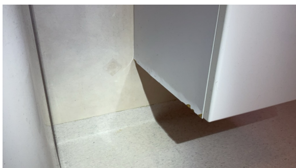
Svelling på innredning.
