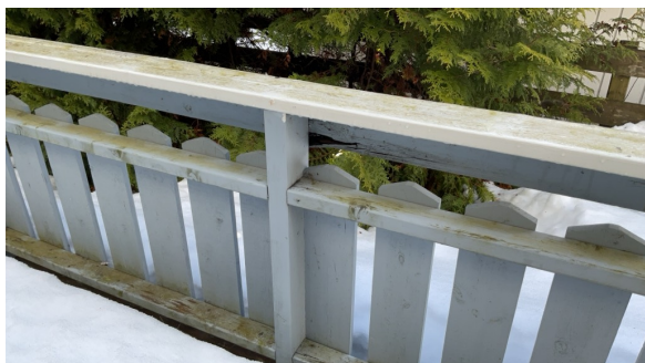
Råteskader på rekkverk.
