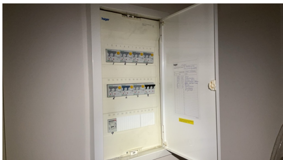
Sikringskap plassert på bod.
