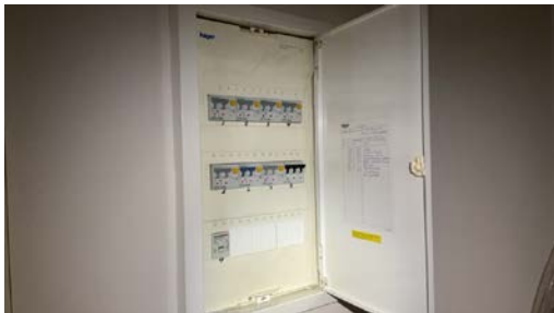
Sikringskap plassert på bod.
