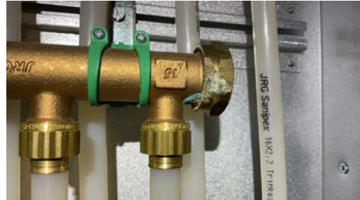
Irr på vannstokk.
