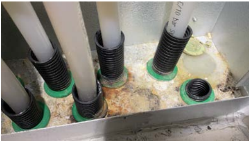
Tegn i fordelingsskap at det tidligere har vært drypplekkasje. Merker var tørre ved befaring
