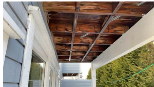
Det er ikke etablert platekledning eller tilsvarende under overliggende terrasse, og nedbør vil derfor dryppe ned på underliggende areal.
