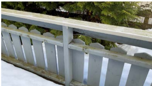
Råteskader på rekkverk.
