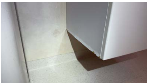
Svelling på innredning.
