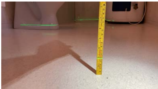
Lokalt motfall mot dør ved at høyeste punkt er midt i rommet.
