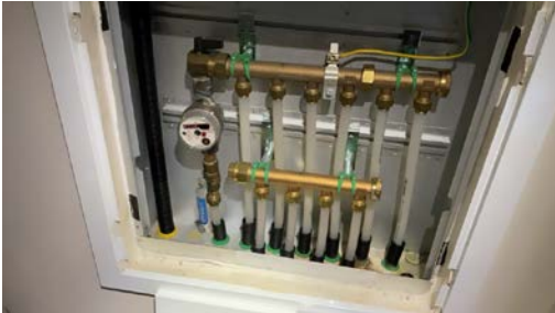
Stoppekran plassert i fordelingsskap.
