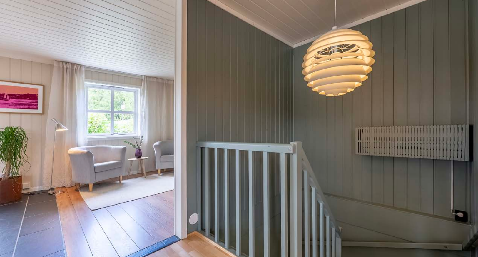
Boligen har luft-luft varmepumpe montert i trapperommet mellom etasjene
