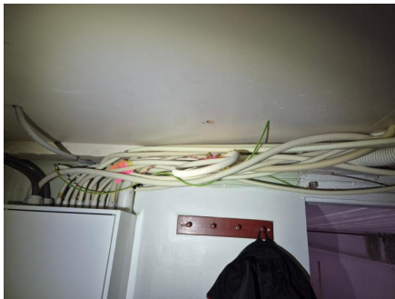
Ledninger er ikke tilstrekkelig festet.
