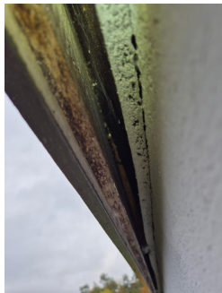
Lufting av kledning, men mangler musesperre.
