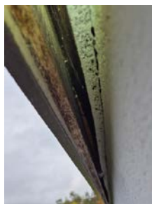
Lufting av kledning, men mangler musesperre.
