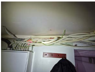
Ledninger er ikke tilstrekkelig festet.
