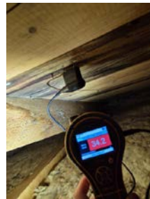
Målt høye fuktverdier i undertak i tilbygg.
