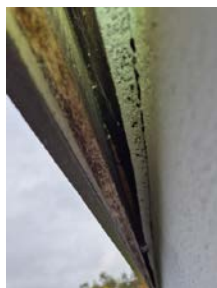
Lufting av kledning, men mangler musesperre.
