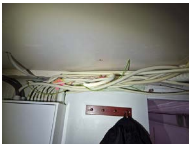
Ledninger er ikke tilstrekkelig festet.
