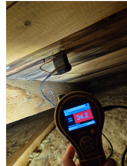
Målt høye fuktverdier i undertak i tilbygg.
