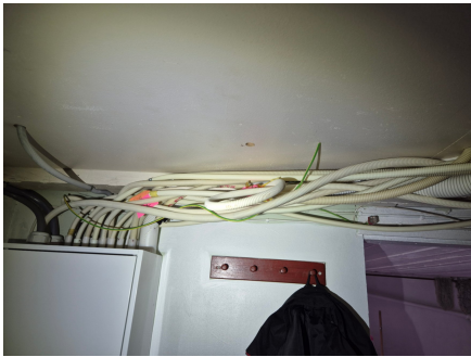
Ledninger er ikke tilstrekkelig festet.
