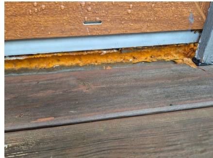
Mangler beslag i underkant av balkongdør.
