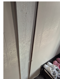
Plate i gang som ikke er tilstrekkelig festet.
