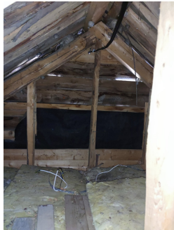
Kun lufting mellom skjøter i kledning i gavlvegg.
