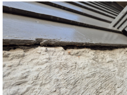
Ingen lufting av kledning og synlig råte i bunn.
