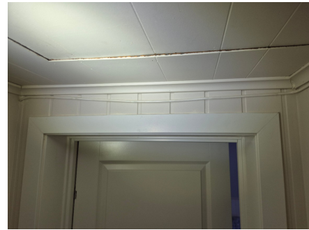
Ledning er ikke tilstrekkelig festet.
