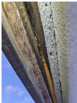
Lufting av kledning, men mangler musesperre.
