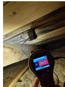
Målt høye fuktverdier i undertak i tilbygg.
