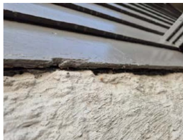
Ingen lufting av kledning og synlig råte i bunn.
