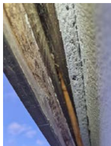
Lufting av kledning, men mangler musesperre.
