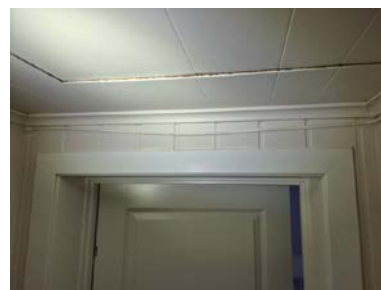
Ledning er ikke tilstrekkelig festet.
