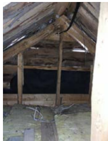
Kun lufting mellom skjøter i kledning i gavlvegg.
