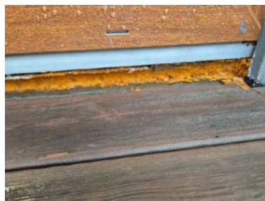
Mangler beslag i underkant av balkongdør.
