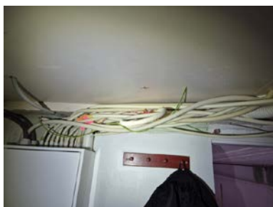
Ledninger er ikke tilstrekkelig festet.
