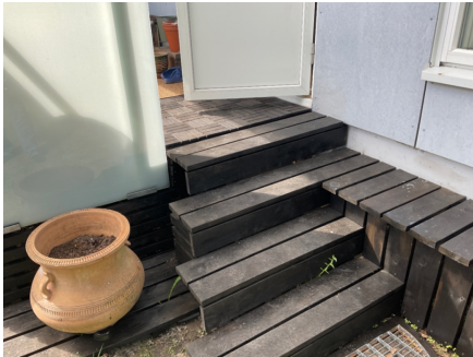
Manglende rekkverk/fallsikring på utvendig trapp.
