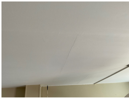
Mindre riss i tak i stue.
