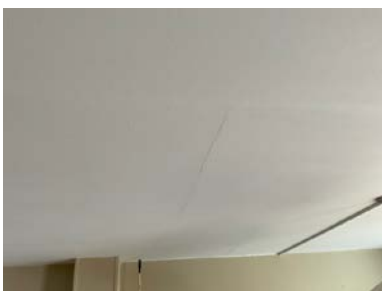
Mindre riss i tak i stue.
