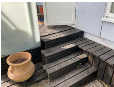
Manglende rekkverk/fallsikring på utvendig trapp.
