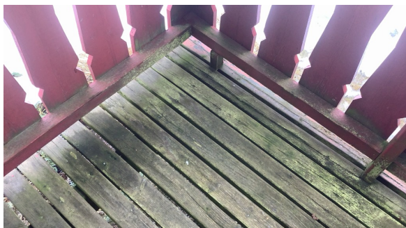
Værslitt terrassegulv med mosegroing.
