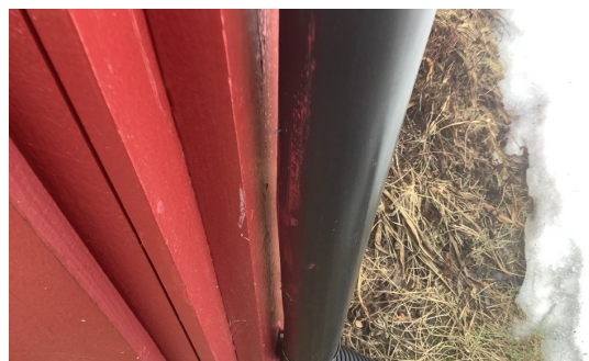
Eksempel på frostsprengt nedløpsrør.
