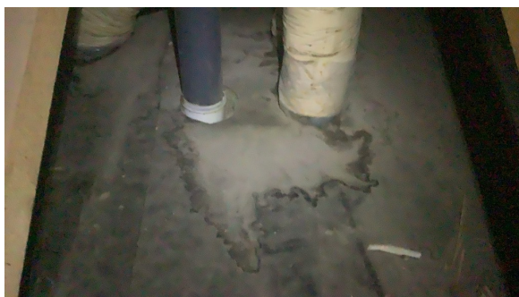
Fuktskjolder under luftehatt.
