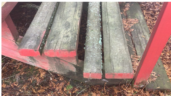
Værslitt trapp til terrassen.
