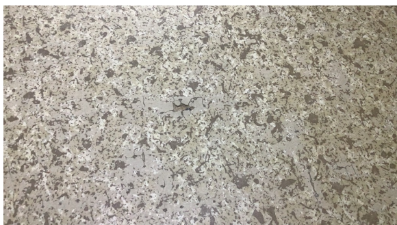
Skade i gulvbelegg.
