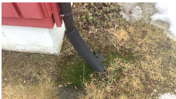
Eksempel på mangelfull bortledning av vann fra taknedløp.
