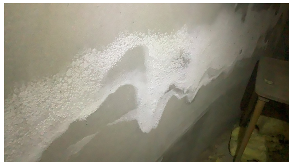
Eksempel på saltutslag.
