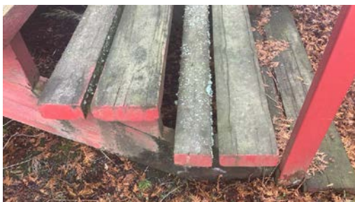
Værslitt trapp til terrassen.
