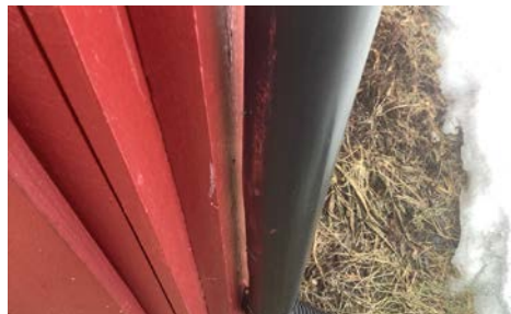
Eksempel på frostsprengt nedløpsrør.
