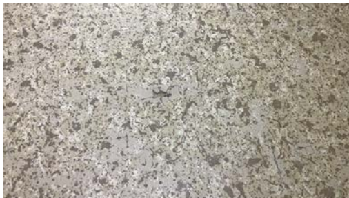
Skade i gulvbelegg.
