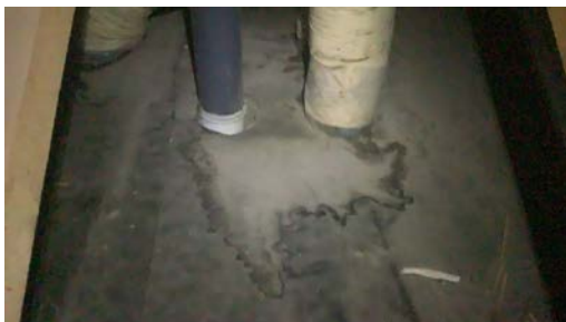
Fuktskjolder under luftehatt.
