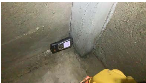
Skadelig fuktinnhold i stolper under repos.
