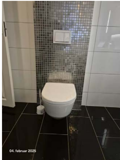
Innebygd sisterner. Ikke registrert lekkasjespalte under WC. Ikke lagt frem dokumentasjon på annen godkjent løsning.
