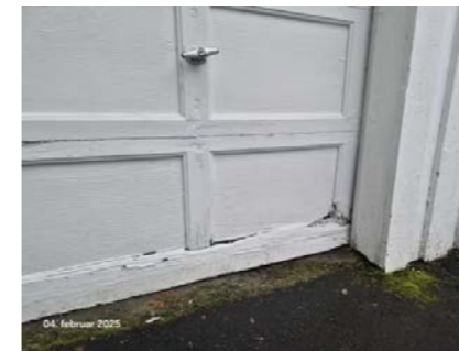
Garasjeport har råteskader.
