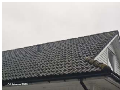
Mosegroing på taktekking
