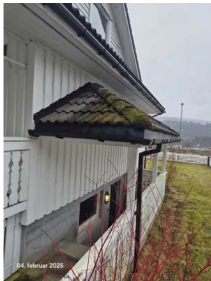
Mosegroing på taktekking.
