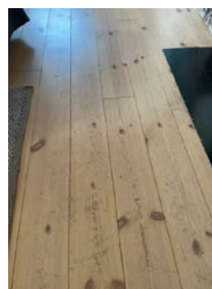
Eksempel på sår og hakk i overflater.
