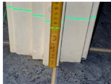
Fallforhold ca. 110 mm overkant gulv ved dørkarm mellom vaskerom og bad
