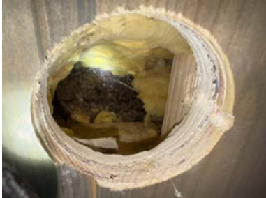
Foto av hulltaking. Misfarget grunnmur og antydning til fukt
