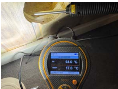
Fuktsøk med pigger i treverk/bunnsvill
