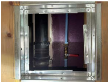
Inspeksjonsluke med stoppekran
