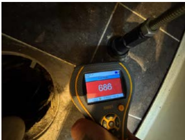
Fuktindikasjon i badegulv
