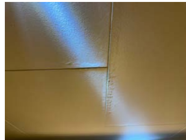
Synlig fukt-/svelleskade på himlingsplater i underliggende bad
