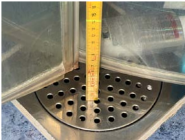
Fallforhold ca. 142 mm topp slukrist i dusjsone
