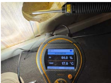
Fuktsøk med pigger i treverk/bunnsvill
