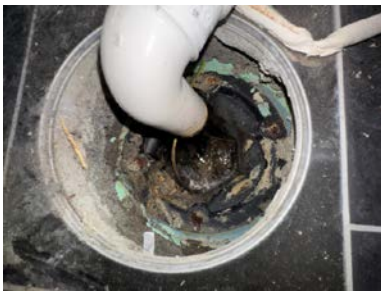
Plastsluk fra byggeår og synlig gulvbelegg under påstøp.
