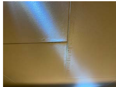
Synlig fukt-/svelleskade på himlingsplater i underliggende bad
