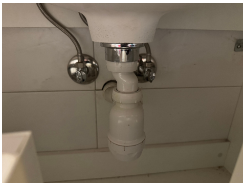
Rørøpplagg under servant.
