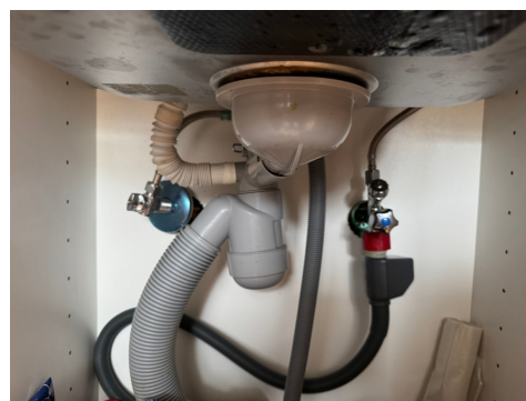
Rørøpplagg under vask.
