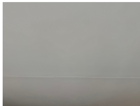
Noe ujevnheter i skjøt i himling i stue/kjøkken. Bør ev. lokal utbedres v/ behov.
