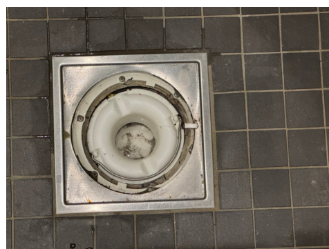
Plastsluk i dusjsone.
