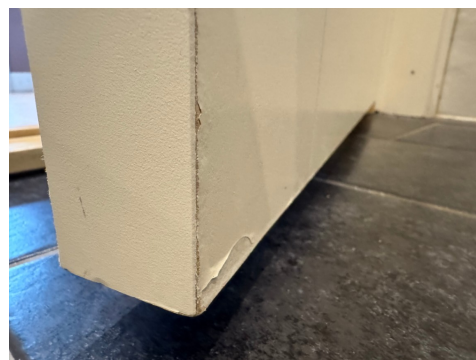
Fuktutsvelling/slitasje i nedre del av badedør.
