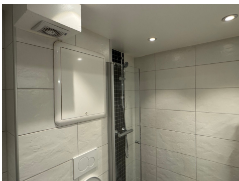
Rør i rør skap i våtsone.
