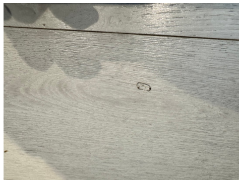
Sår i laminat i stue/kjøkken. Må anses å være normal slitasje.
