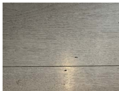
Sår i laminat i stue/kjøkken. Må anses å være normal slitasje.
