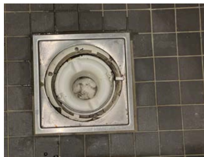
Plastsluk i dusjsone.
