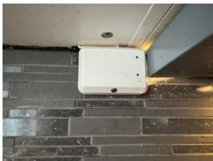
Komfyrvakt v/ kjøkkenventilator.
