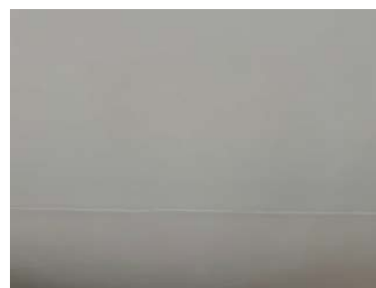
Noe ujevnheter i skjøt i himling i stue/kjøkken. Bør ev. lokal utbedres v/ behov.
