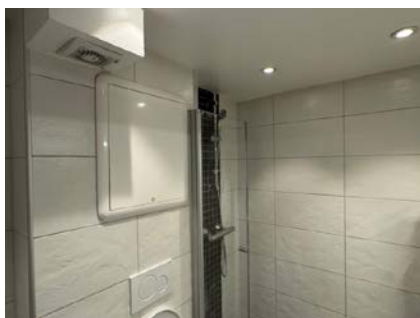
Rør i rør skap i våtsone.
