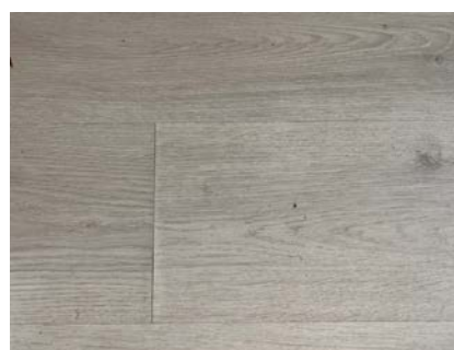
Fuktutsvelling i laminatskjøt i entre/gang. Må anses å være normal slitasje.
