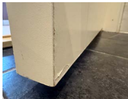
Fuktutsvelling/slitasje i nedre del av badedør.
