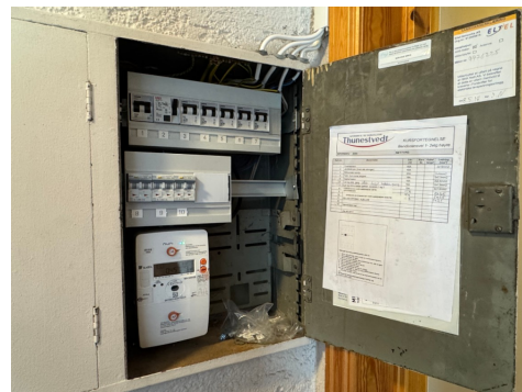
Sikringsskap i fellesarealer.
