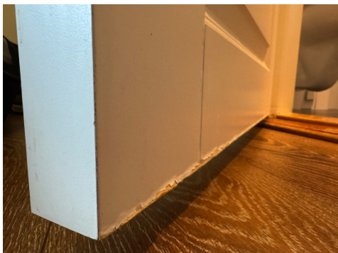
Fuktsvelling/slitasje i nedre del av badedør.
