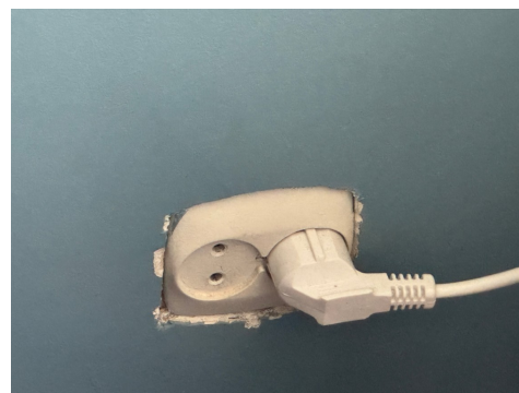
Eldre stikkontakt på soverom 2. Det er montert veggplater rundt stikkontakt (ukurant løsning).
