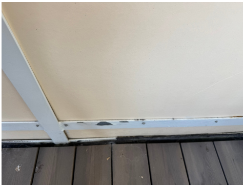
Noe malingsflass på stålprofil på rekkverk. Bør ev. males/vedlikeholdes.
