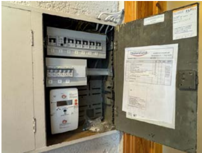
Sikringsskap i fellesarealer.
