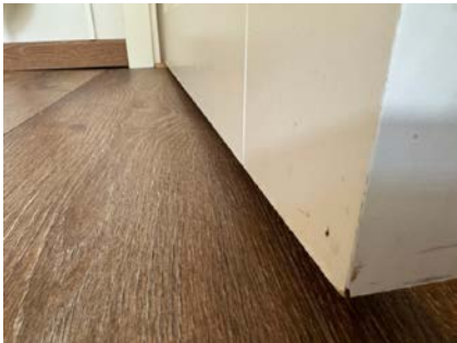
Fuktutsvelling/slitasje i nedre del av kjøkkendør.
