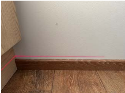
Bilder viser skjevheter i gulv på kjøkken.
