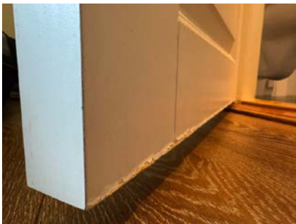
Fuktutsvelling/slitasje i nedre del av badedør.
