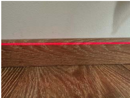
Bilder viser skjevheter i gulv på kjøkken.
