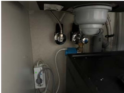
Røropplegg og aquastop under vask.
