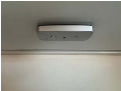
Komfyrvakt v/ kjøkkenventilator.
