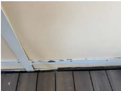
Noe malingsflass på stålprofil på rekkverk. Bør ev. males/vedlikeholdes.
