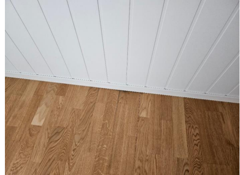
Det er fuktskade på parkett under vindu.
