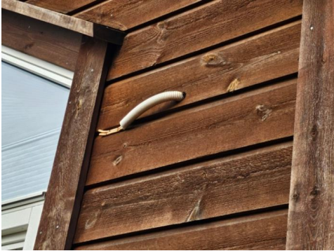
Trekkerør med kabler
