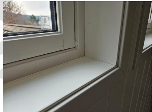
Foring på vinduer har svellet litt opp.
