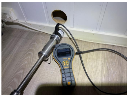
Bruk av hammerelektrode fra soverom mot sør.
