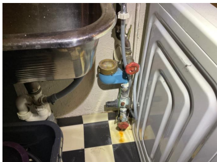
Stoppekran og vannmåler
