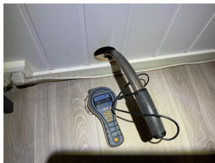
Soverom 2 ved siden av uisolert lagerrom
