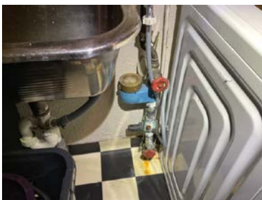
Stoppekran og vannmåler
