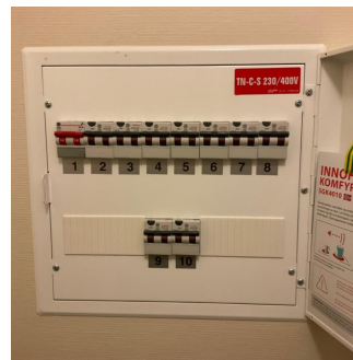
Innmat i sikringsskap med automatsikringer
