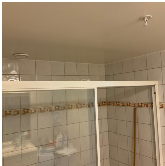
Avtrekkventil i himling, samt dyse m/ ampull for sprinkleranlegg
