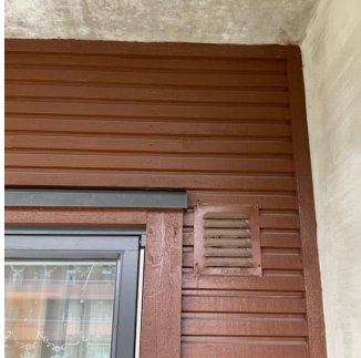
Tilluft til soverom via ventil i yttervegg
