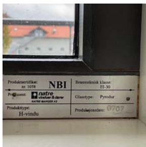
Vinduer ved svalgang er brannklassifisert EI-30
