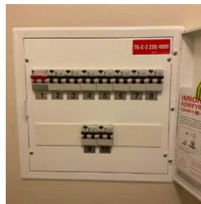
Innmat i sikringsskap med automatsikringer
