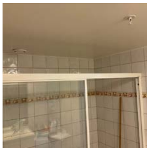
Avtrekksventil i himling, samt dyse m/ ampull for sprinkleranlegg
