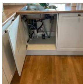
Rørpropp i kjøkkenbenk _ stengeventil _ varmtvannsbereider
