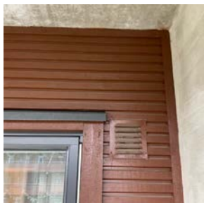
Tilluft til soverom via ventil i yttervegg
