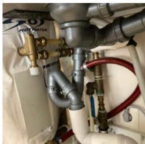
Installert i hjørne av kjøkkenbenk
