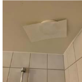
Test med ark _ ok. Hastighet reguleres ved kjøkkenventilator
