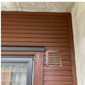
Tilluft til soverom via ventil i yttervegg
