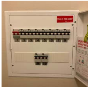
Innmat i sikringskap med automatsikringer
