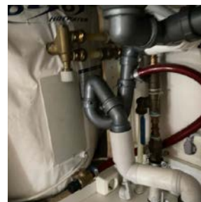
Berederen er installert i hjørne av kjøkkenbenk - Frakoplet ved befaring 9. okt. '25
