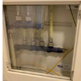
Fordelerskap i vegg på badrom
