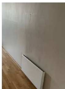
Stuevegg med rift i tapetduk og misfarging over panelovn
