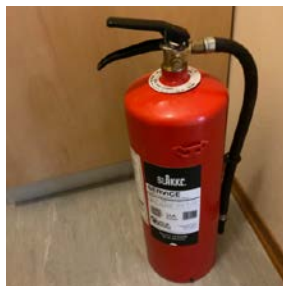
Pulverapparat er kontrollert i januar '25
