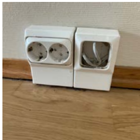
Mangler deksel på boks ved siden av stikk på soverom
