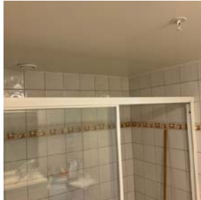
Avtreksventil i himling, samt dyse m/ ampull for sprinkleranlegg
