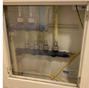
Fordelerskap i vegg på badrom
