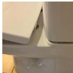
Løs innfesting av dosete / lokk
