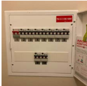
Innmat i sikringskap med automatsikringer
