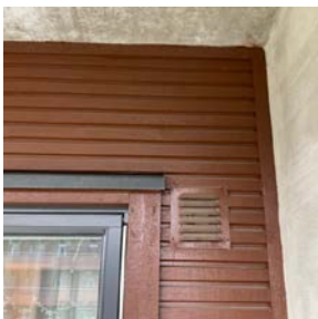
Tilluft til soverom via ventil i yttervegg
