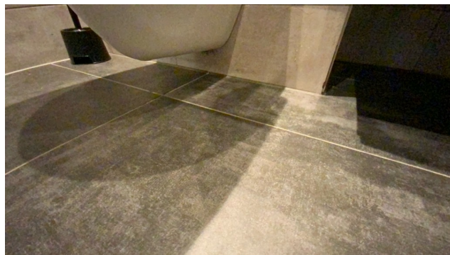
Lekkasjespalte på innebygget sistene bør opparbeides.
