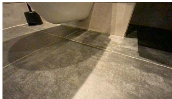
Lekkasjespalte på innebygget sisterner bør opparbeides.
