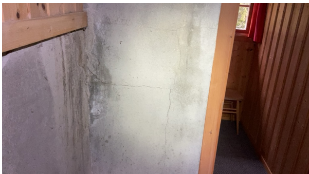
Sprekkdannelse i pipe
