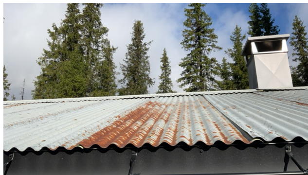
Rustskade på tekking
