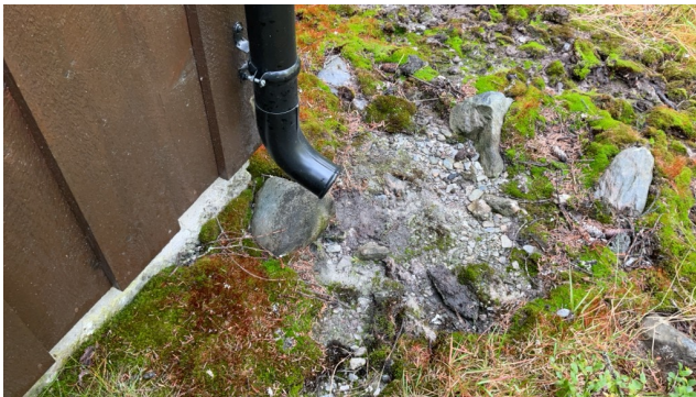
Takvann bør ledes vekk fra bygningskropp
