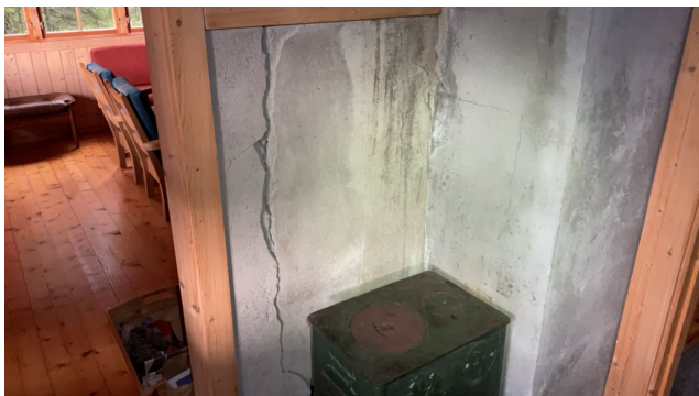
Sprekker og setningsskader i brannmur
