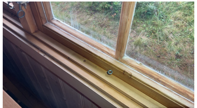
Vedlikeholdsbehov av vinduer
