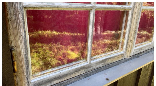
Stor grad av vedlikeholdsbehov og evt. utskifting bør vurderes
