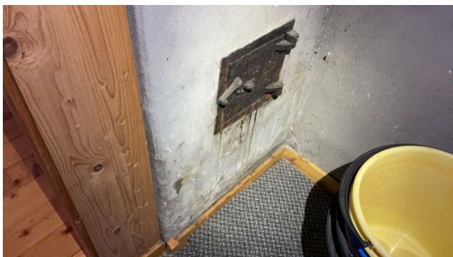
Manglende ubrennbar plate til sotluke og rust/fuktmerker fra sotluke. Brennbart materiale er etablert inntil pipe og ikke egnet
