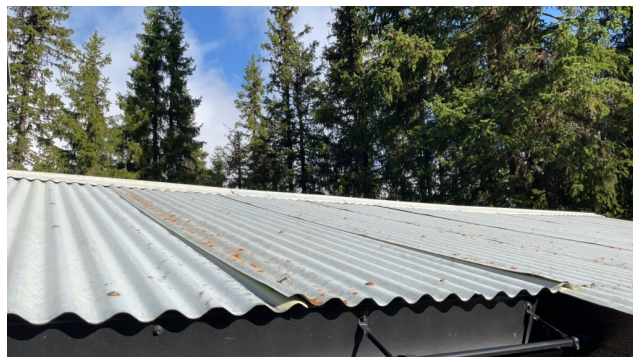
Løs skjøtende med fare for klapping
