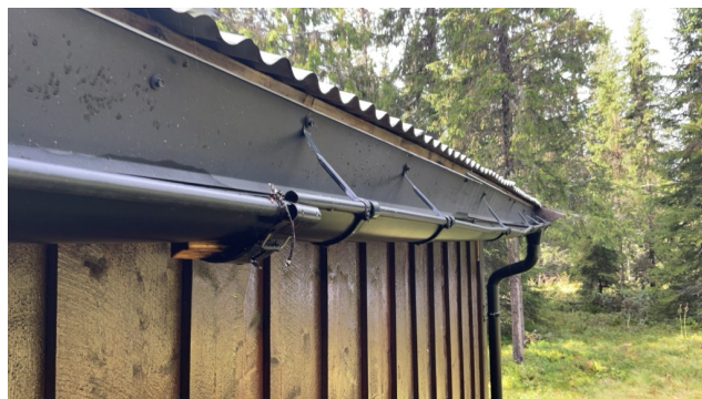
Nedbøyning av takrenne
