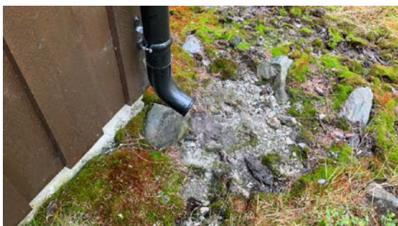
Takvann bør ledes vekk fra bygningskropp
