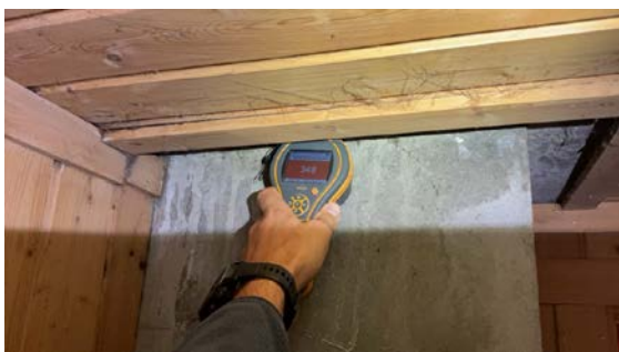
Fuktmerker på pipestamme, ved fuktmåletaking med overflatesøk var det fuktutslag der tiltak må foretas
