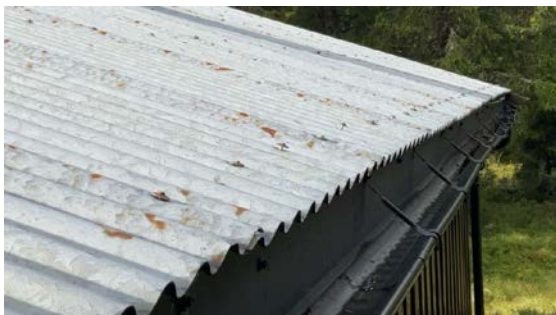
Synlig utettheter med spikeropptrekk
