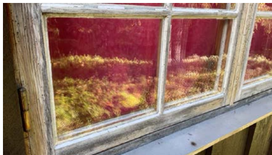
Stor grad av vedlikeholdsbehov og evt. utskifting bør vurderes
