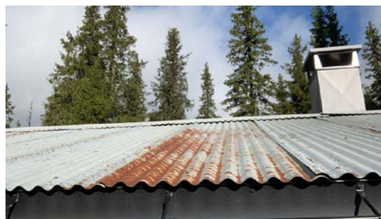
Rustskade på tekking
