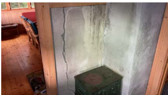
Sprekker og setningsskader i brannmur
