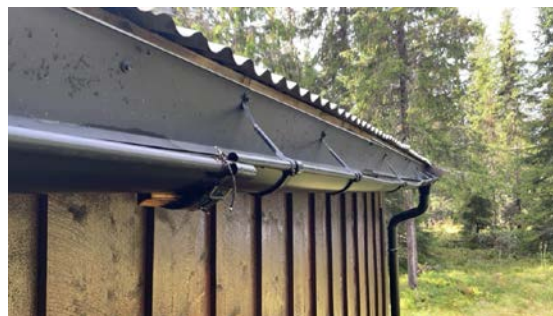
Nedbøyning av takrenne
