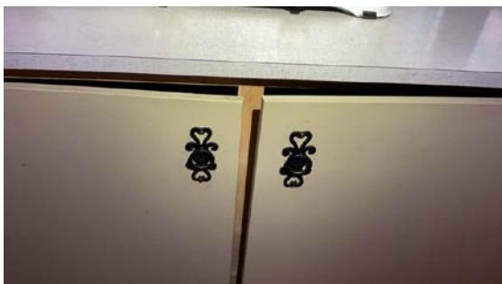
Skjevheter i innredning der dører lar seg ikke lukke
