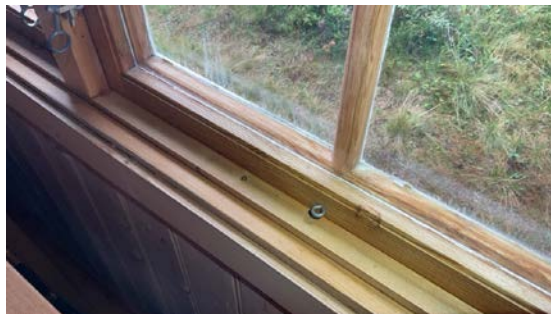
Vedlikeholdsbehov av vinduer
