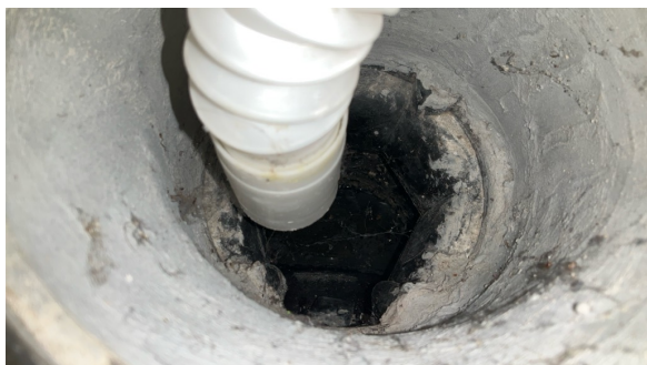
Sluk under dusjkabinett.
