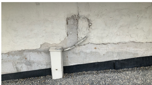
Utvendig kabel er ikke beskyttet
