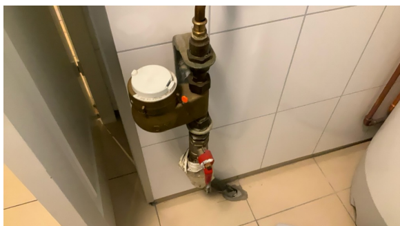
Stoppekran og vannmåler
