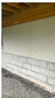
Det er påvist sprekker i murte/pussede fasader.
