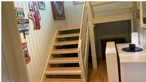
Det mangler håndløper på vegg i trappeløpet.
