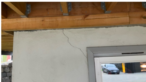
Det er påvist sprekker i murte/pussede fasader.
