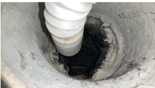
Sluk under dusjkabinett.
