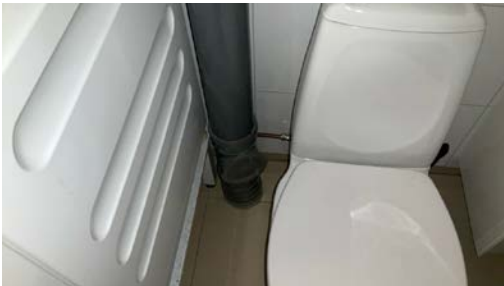
Stakeluke på bad i u.et.
