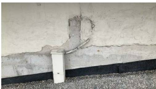
Utvendig kabel er ikke beskyttet
