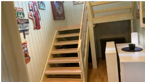
Det mangler håndløper på vegg i trappeløpet.
