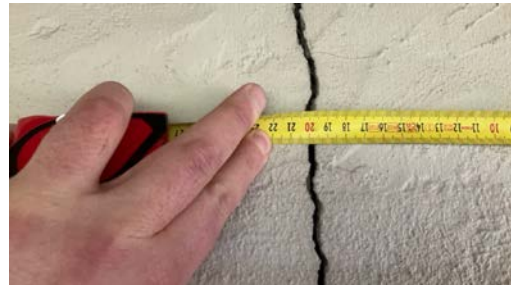
Det er påvist sprekker i murte/pussede fasader.
