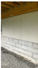
Det er påvist sprekker i murte/pussede fasader.
