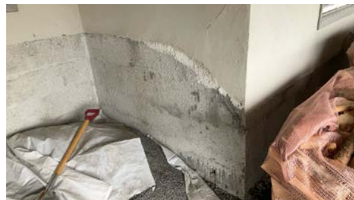
• Nedre del av yttervegg er ikke pusset.
