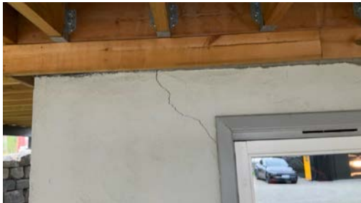
Det er påvist sprekker i murte/pussede fasader.
