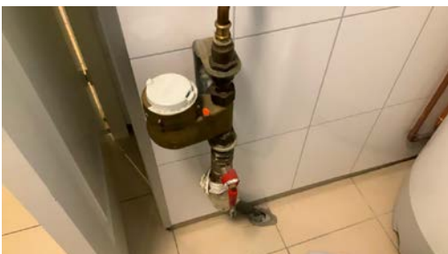
Stoppekran og vannmåler
