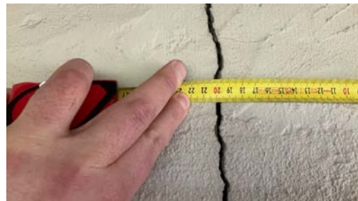
Det er påvist sprekker i murte/pussede fasader.
