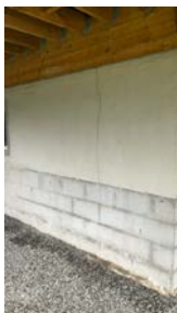
Det er påvist sprekker i murte/pussede fasader.
