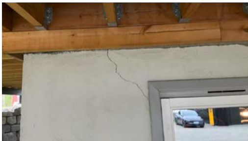
Det er påvist sprekker i murte/pussede fasader.
