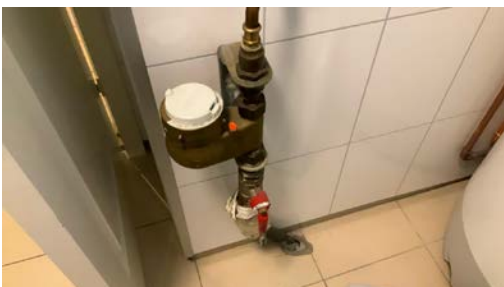
Stoppekran og vannmåler
