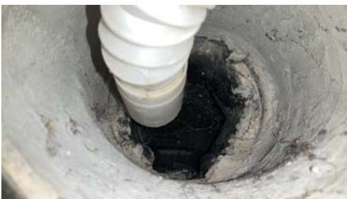
Sluk under dusjkabinett.
