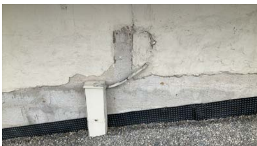
Utvendig kabel er ikke beskyttet
