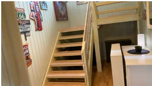
Det mangler håndløper på vegg i trappeløpet.
