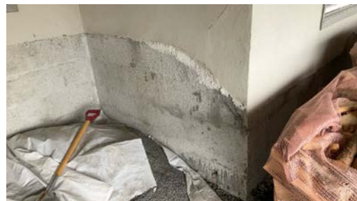
• Nedre del av yttervegg er ikke pusset.
