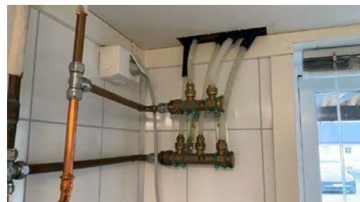
Fordelerstokker montert åpent på vegg.
