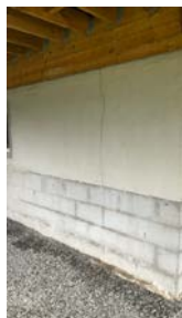
Det er påvist sprekker i murte/pussede fasader.
