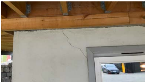
Det er påvist sprekker i murte/pussede fasader.
