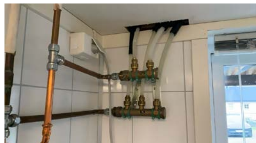
Fordelerstokker montert åpent på vegg.
