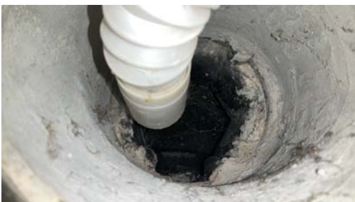
Sluk under dusjkabinett.
