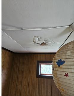
Fuktskade i himling på soverom 1. etasje.
