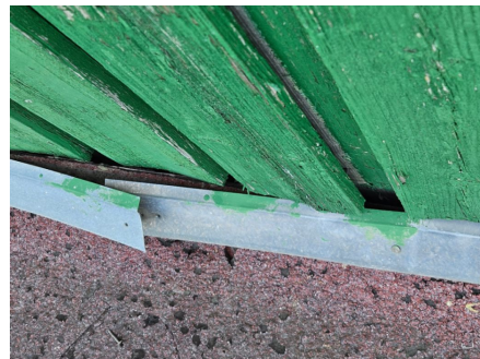
Feil utført avslutning for taktekking mot vegg.
