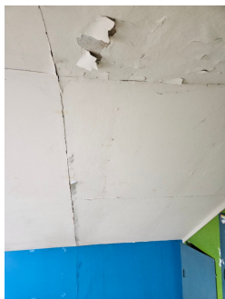
Fuktskader i himling og vegg for ett soverom i 2. etasje.
