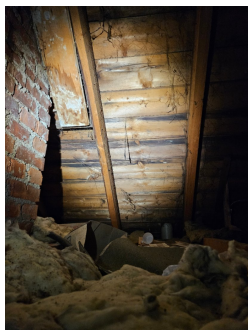
Fuktmerker i undertak for hoveddelen.
