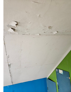
Fuktskade på vegg og himling på soverom i 2. etasje
