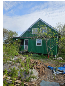
Nedbøyning på takonstruksjon for tilbygg.
