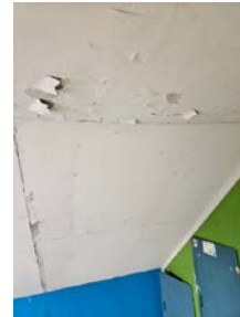
Fuktskade på vegg og himling på soverom i 2. etasje
