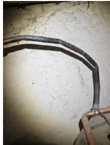
Vannrør til varmtvannsbereder.
