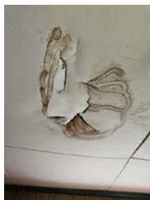
Skade i himling på soverom i tilbygg 1. etasje.
