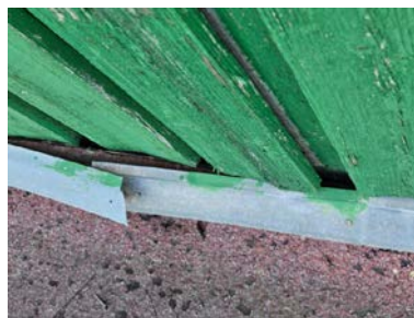
Feil utført avslutning for taktekking mot vegg.
