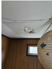
Fuktskade i himling på soverom 1. etasje.
