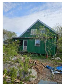
Nedbøyning på takonstruksjon for tilbygg.
