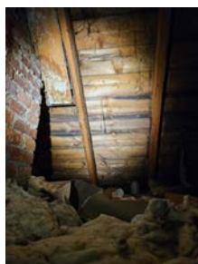
Fuktmerker i undertak for hoveddelen.
