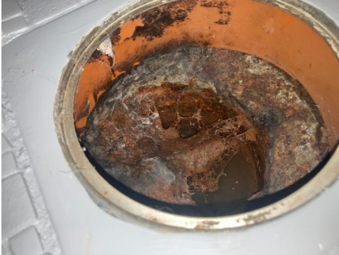
Støpejernssluk under kabinett.
