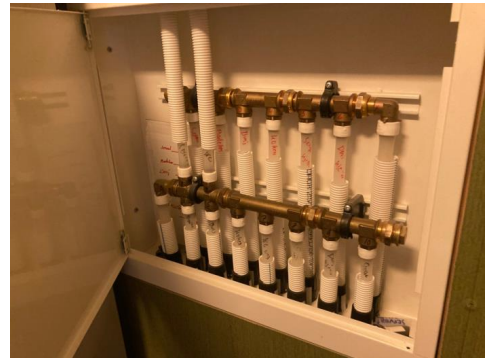
Fordelerskap i bod med drenering til bad 1.etasje.
