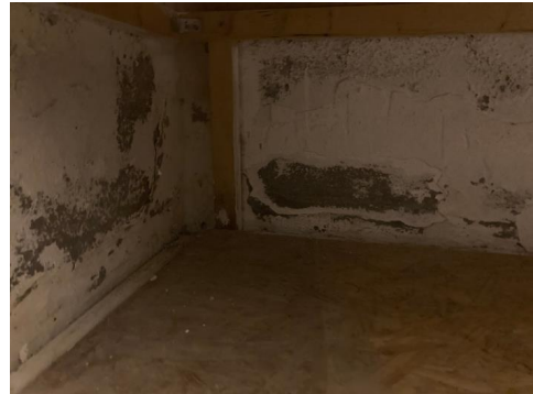
Saltutslag på vegg i bod under garasje.
