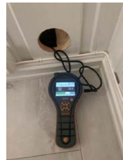
Fuktmåling i utforet vegg viste normale verdier.
