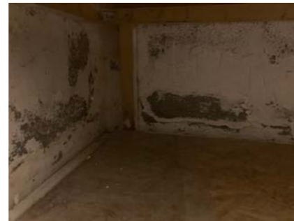
Saltutslag på vegg i bod under garasje.
