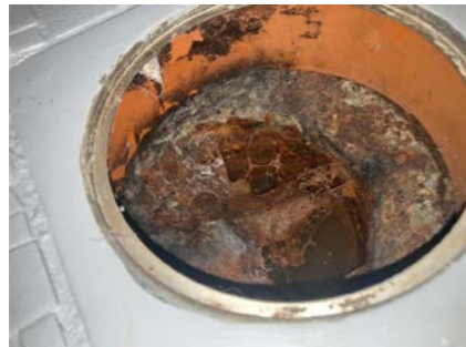
Støpejernssluk under kabinett.
