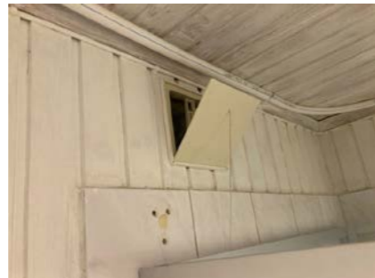
Naturlig ventilering av badet.
