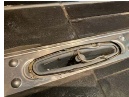
Veggsluk i dusjsone.
