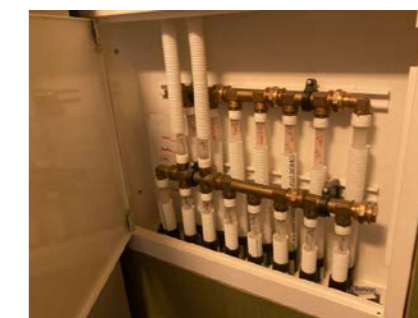
Fordelerskap i bod med drenering til bad 1.etasje.
