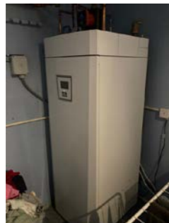
Varmtvannstank i teknisk rom.
