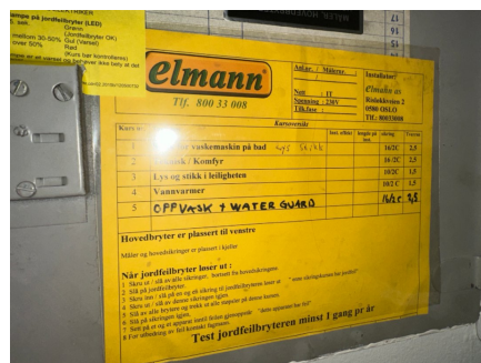
Kursoversikt i sikringsskap
