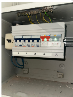
Sikringsskap med automatsikringer.
